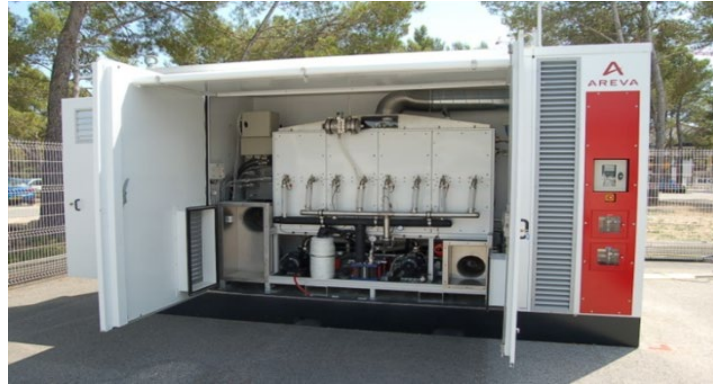
Figure 25. Alimentation de secours à pile à combustible couplée à un centre de données IP Energy.
