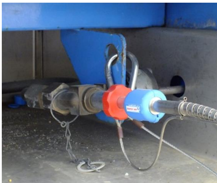
Figure 57 : Vanne principale de remorque de H2 (vue intérieure) © Areva/ENSOSP 2015
