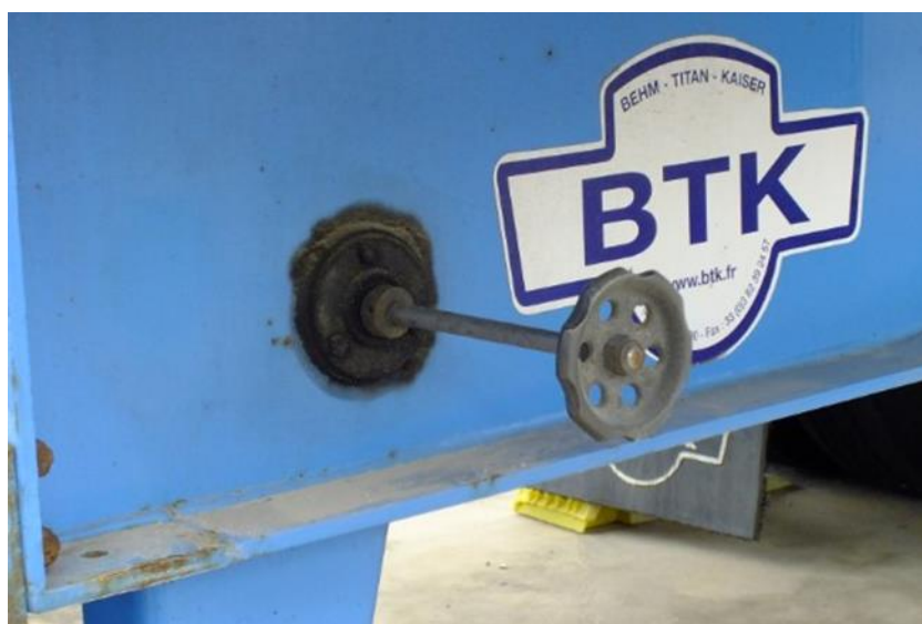
Figure 56 Vanne principale de remorque de H2 (vue extérieure) © Areva/ENSOSP 2015
