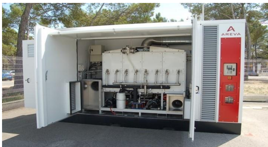
Figure 14 : Alimentation de secours de la pile à combustible associée au centre de données IP Energy.
