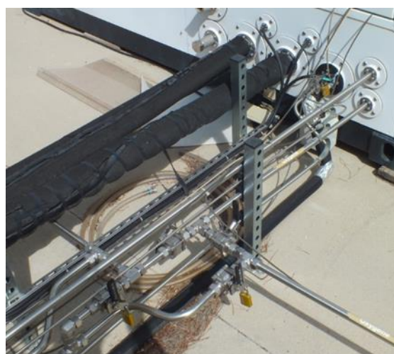
Figure 69 : Figure 35 Système de secours Areva (détails du réseau H2 et O2 avec vannes) ©AREVA/ENSOSP 2015
