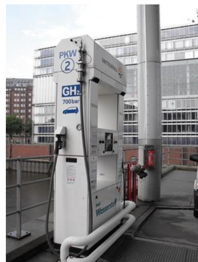
Figure 35 : Distributeur 700 bar (Vattenfall-Hambourg)
