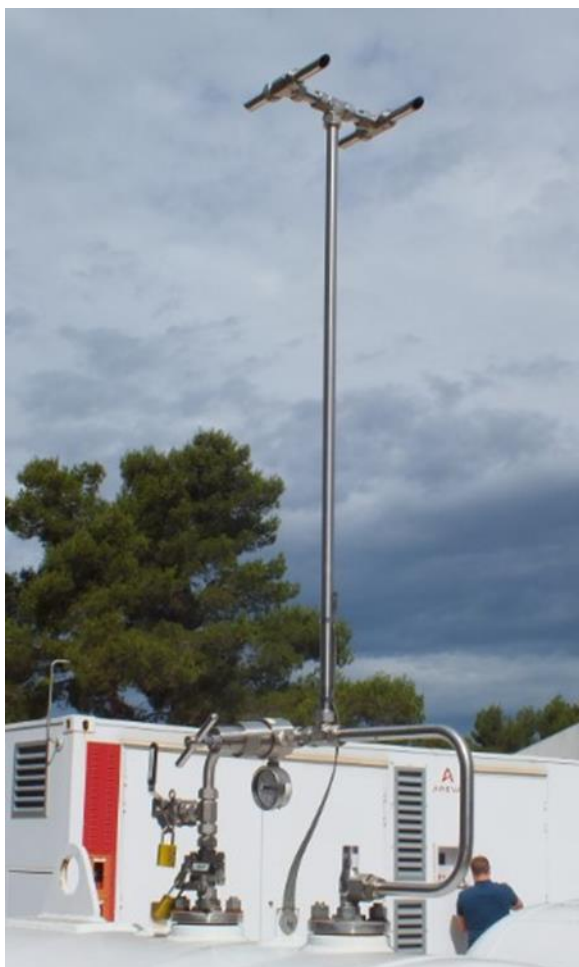
Figure 67 : Système de secours Areva (dispositifs de décompression) ©AREVA/ENSOSP 2015
