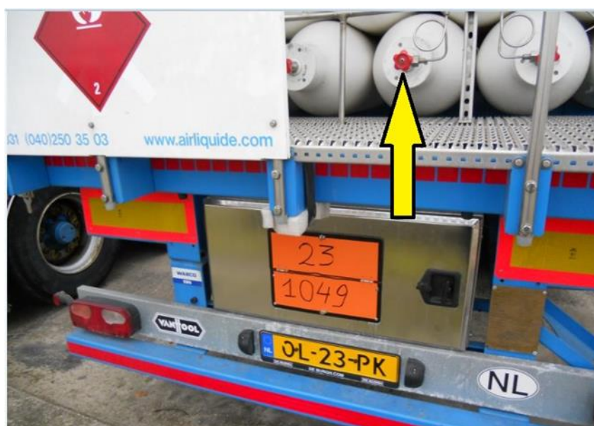
Figure 53 : Vanne de bombonne individuelle sur une remorque de H2.
