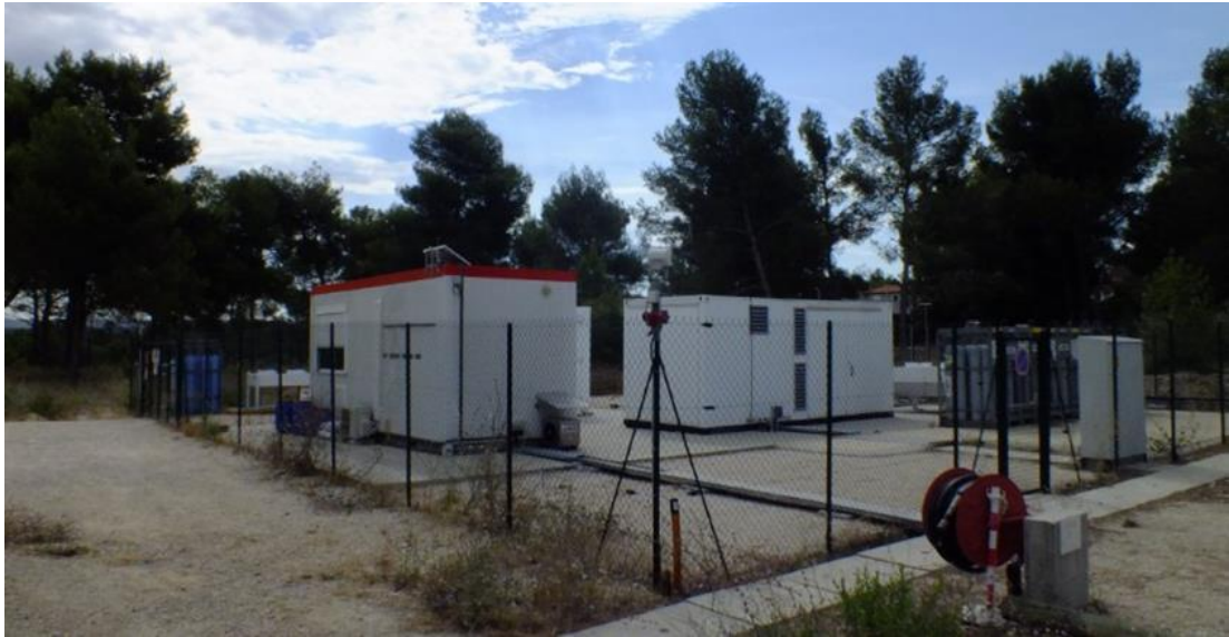
Figure 64 : Vue globale du système de secours Areva ©AREVA/ENSOSP 2015
