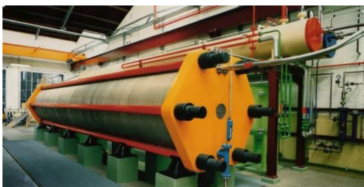
Figure 19 : Électrolyseur alcalin IHT type S-556, 760 Nm 3 /h et 30 bar
