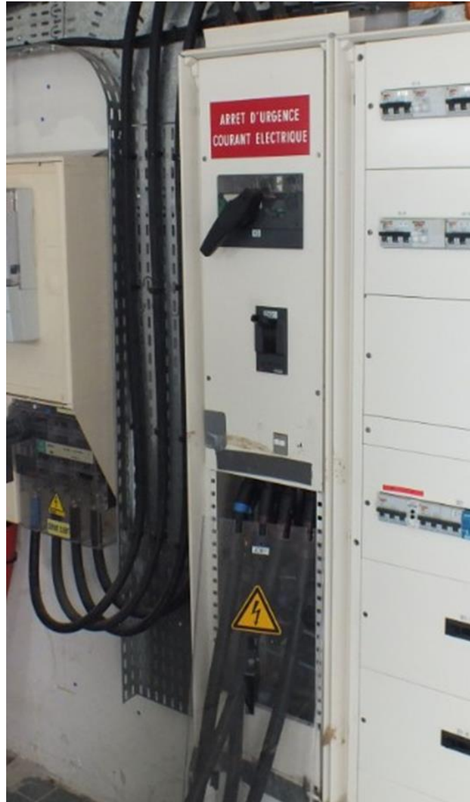
Figure 59 : Disjoncteur principal d'urgence © Areva/ENSOSP 2015
