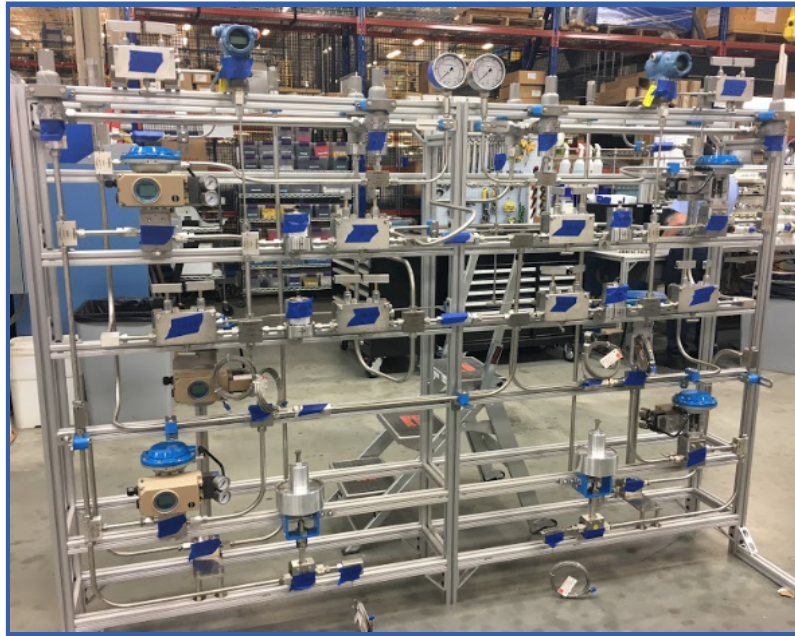
Figura 24. Panel de válvulas.
