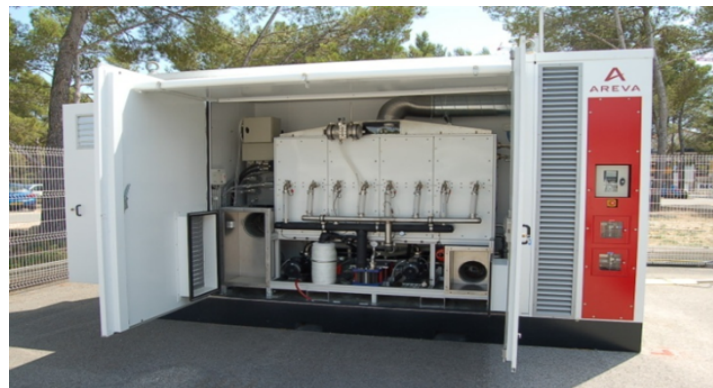
Figura 18 Potencia de reserva de FC acoplada al centro de datos de IP Energy.
