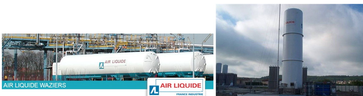
Abbildung 3. Horizontale und vertikale Flüssigwasserstoffspeicher. (Quelle: Air Liquide).
