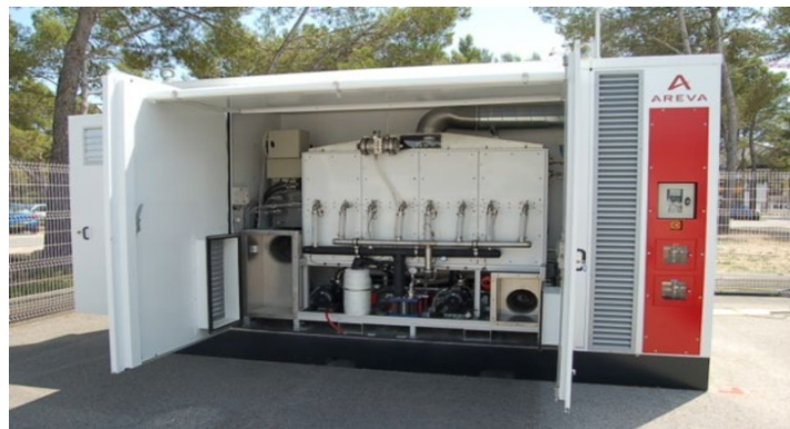
Figura 25. Un sistema di alimentazione di back-up FC nel data center IP Energy.
