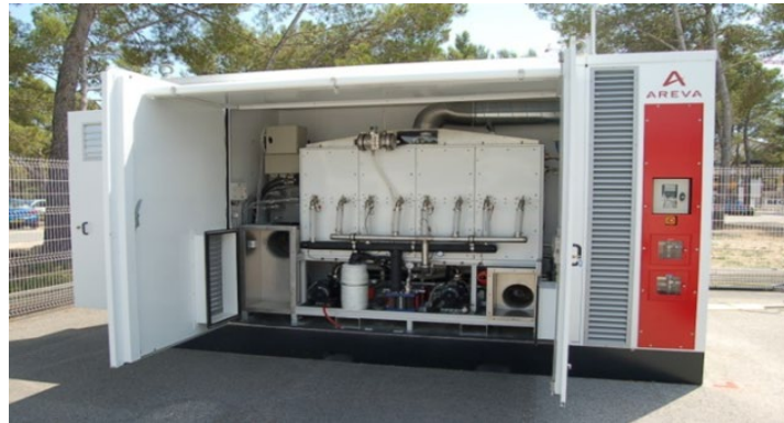
Abbildung 25. Eine FC-Notstromversorgung gekoppelt mit einem IP Energy-Rechenzentrum.
