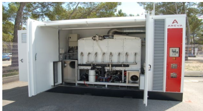
Figura 19. Un sistema di alimentazione di back-up FC nel data center IP Energy.
