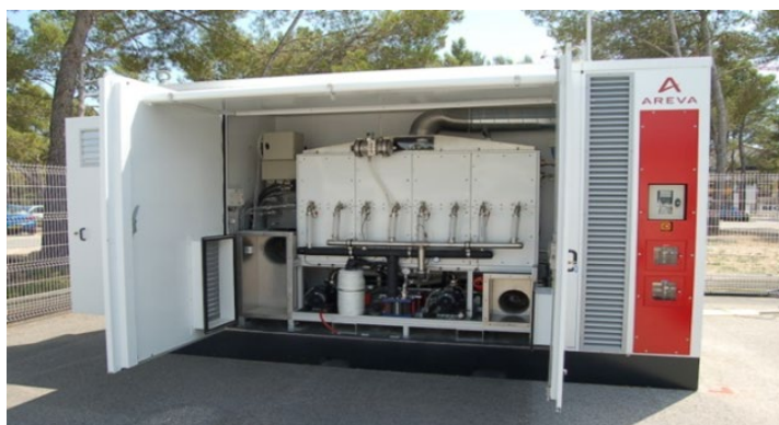
Obr. 18 UPS s vodíkovými palivovými články ve spojení s datovým centrem IP Energy.
