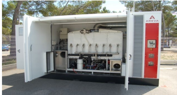
Abbildung 18. Eine FC-Notstromversorgung gekoppelt mit einem IP Energy-Rechenzentrum.
