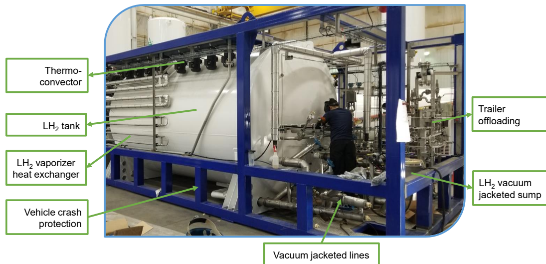
Figura 13. Panoramica skid LHRs – lato “criogenico”. Componenti in senso orario: scarico del trailer, estrazione LH 2 , linee coibentate, protezione da urto/impatto di veicoli, scambiatore di calore vaporizzatore LH 2 , serbatoio di LH 2 , termoconvettore.
