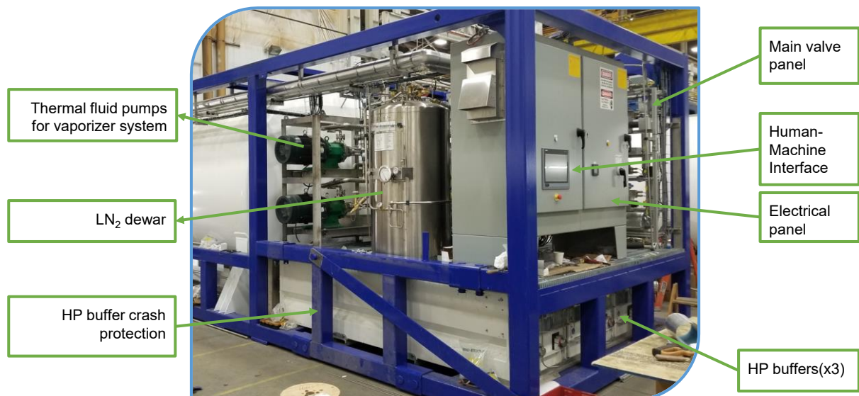
Figura 14. Panoramica skid LHRs – lato “caldo”. Componenti in senso orario: pannello valvole principale, interfaccia uomo-macchina, pannello elettrico, buffers alta pressione, protezione da urto o impatto del buffer alta pressione, dewar LN 2 , pompe di termo fluidi per il sistema di vaporizzazione.
