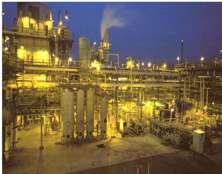
Figura 30. Impianto SMR di Air Liquide.
