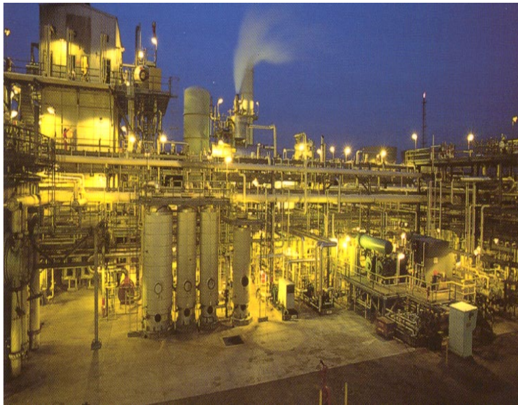
Obrázek 30. Závod společnosti Air Liquide na parní reformování metanu.
