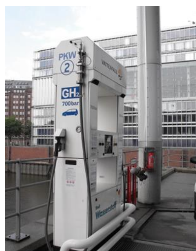
Figura 35: Distributore 700 bar (Vattenfall-Hamburg).
