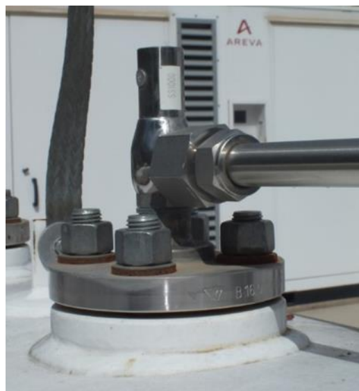
Figura 68: Sistema di backup Areva (dettaglio del dispositivo per il rilascio di pressione). ©AREVA/ENSOSP 2015
