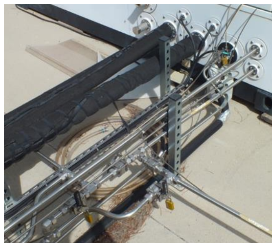
Figura 69: Sistema di backup Areva (dettaglio della rete H2 and O2 con valvole). ©AREVA/ENSOSP 2015
