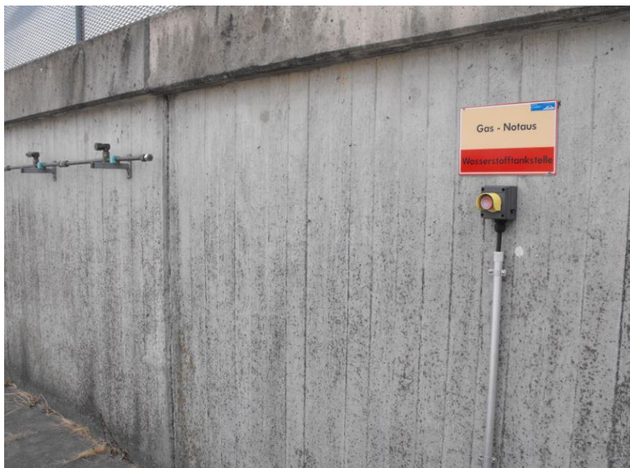
8.3. Figura 40: Stazione di rifornimento ESD a distanza dal distributore (Hamburg airport).
