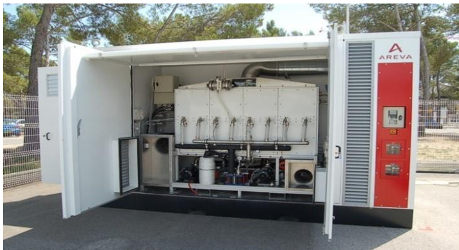
Figura 14: Fuel Cell per potenza di backup presso l'IP Energy data center.
