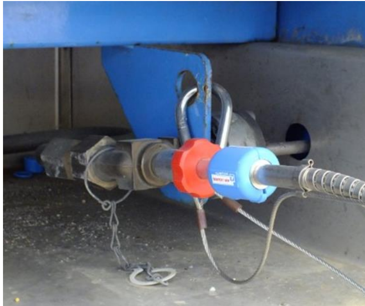
Figura 57: Valvola H2 principale del trailer (vista esterna). © Areva/ENSOSP 2015
