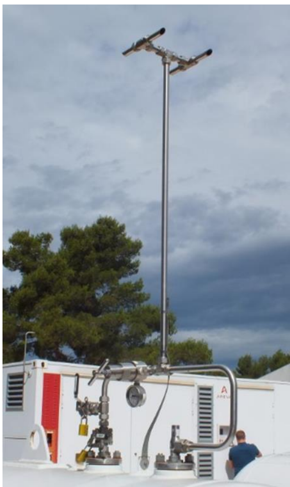
Figura 67: Sistema di backup Areva (dispositivo per il rilascio della pressione). ©AREVA/ENSOSP 2015
