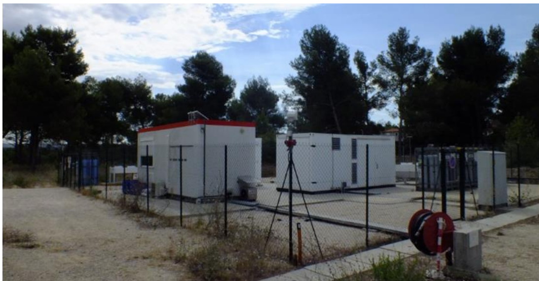
Figura 64: Sistema di backup Areva vista globale. ©AREVA/ENSOSP 2015
