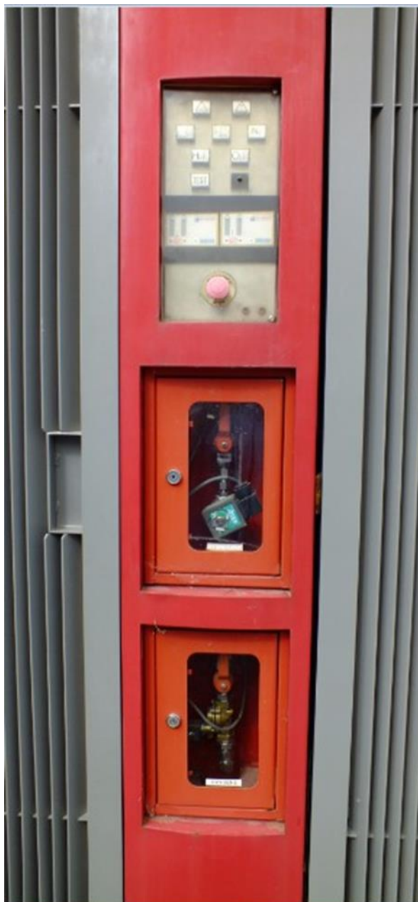
Figura 70: Spegnimento di emergenza e delle valvole H2/O2 sulla green box AREVA. ©AREVA/ENSOSP 2015
