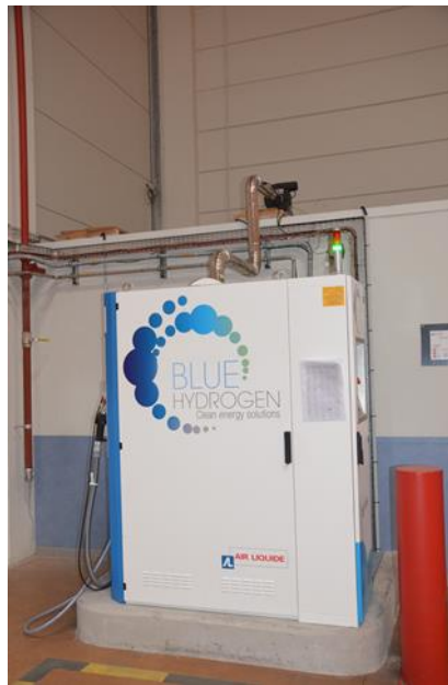
Figura 37: Stazione di rifornimento interna per carrelli elevatori (dispenser).
