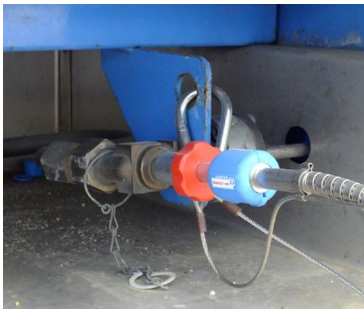
Obrázek 57: Hlavní ventil návěsu na H2 (pohled zevnitř) © Areva/ENSOSP 2015
