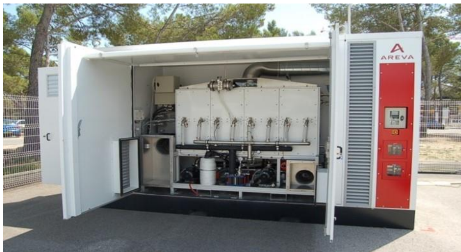
Obrázek 14: Záložní napájení palivovými články připojené k datovému centru společnosti IP Energy.
