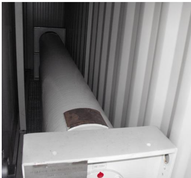
Obrázek 39: Vysokotlaký zásobník čerpací stanice 1 000 bar
