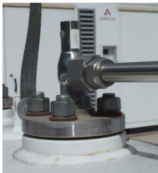
Obrázek 68: Záložní systém Areva (detail zařízení pro uvolnění přetlaku) ©AREVA/ENSOSP 2015
