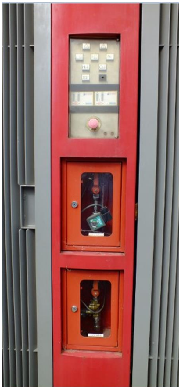
Obrázek 70: Nouzový vypínač a ventily H 2 /O 2 na jednotce AREVA Green Box ©AREVA/ENSOSP 2015
