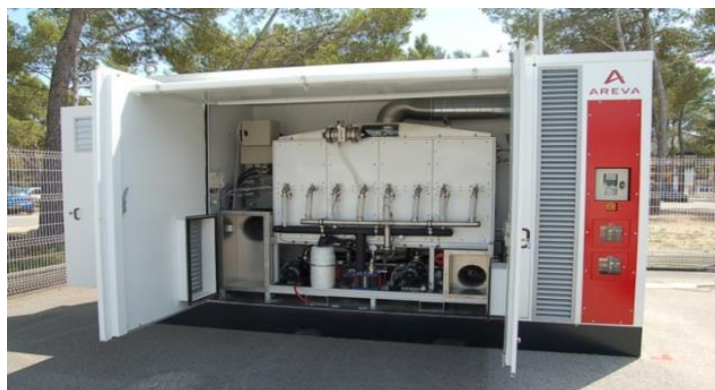
Figuur 20. Een noodstroomvoorziening met brandstofcel verbonden met het datacenter van IP Energy.
