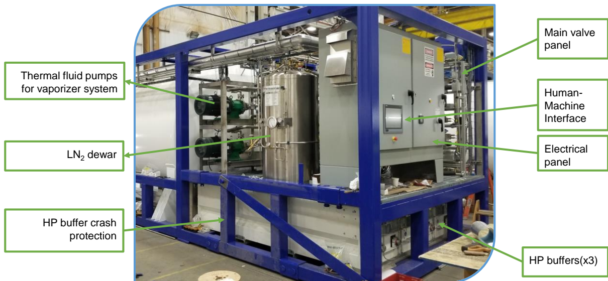
Figuur 14. Overzicht inbouwkast tankstation vloeibare waterstof – "warme" kant.
